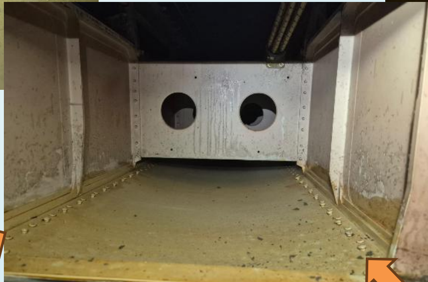
Nesprávně zanýťované nýty
